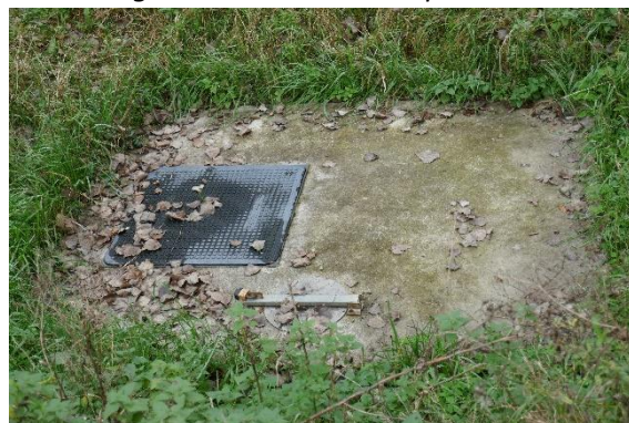
Regulační komora se šoupětem
