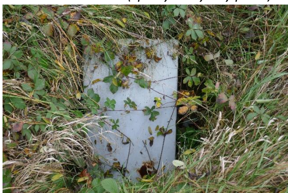
Kanalizační šachta (spadlý zákrytový plech)
