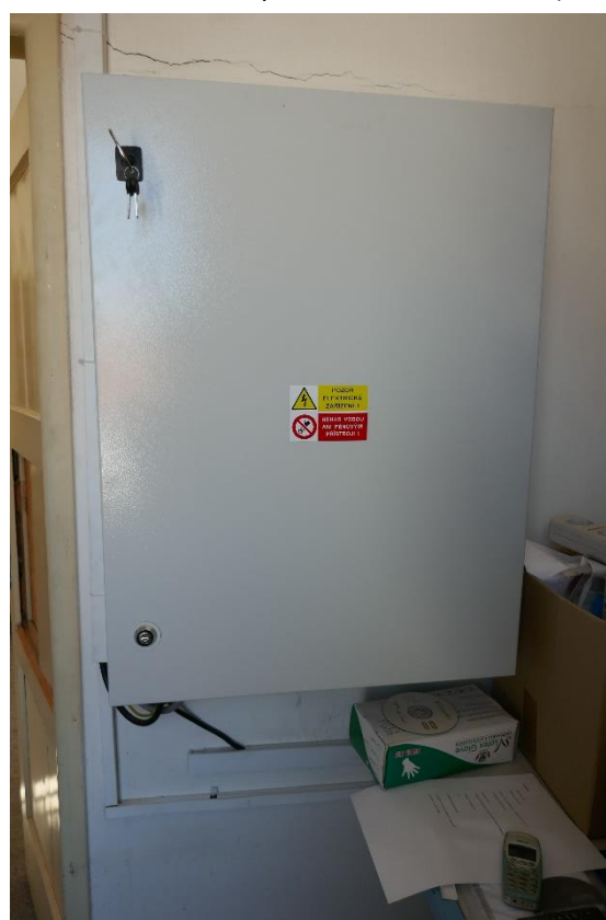
Elektronika sirény v místnosti s rozhlasem
