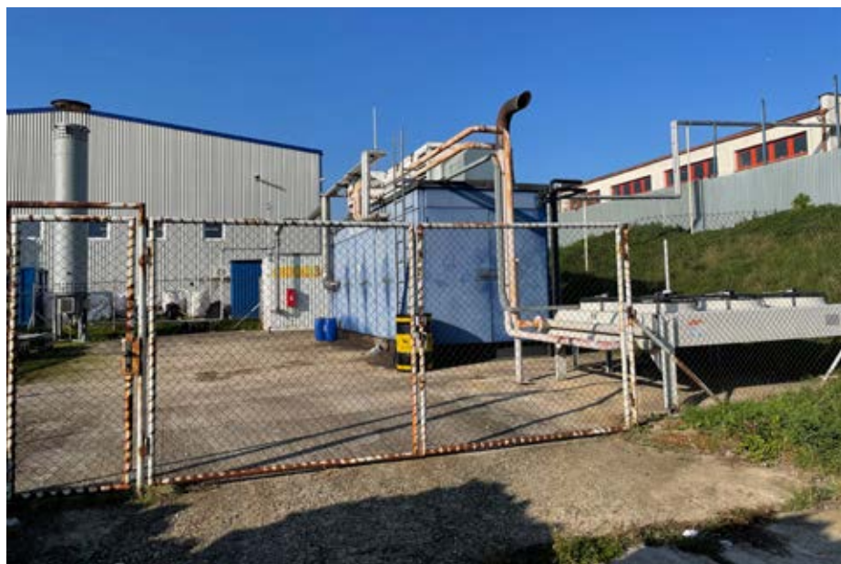
Modrý kontejner – kogenerační jednotka, vlevo fléra
